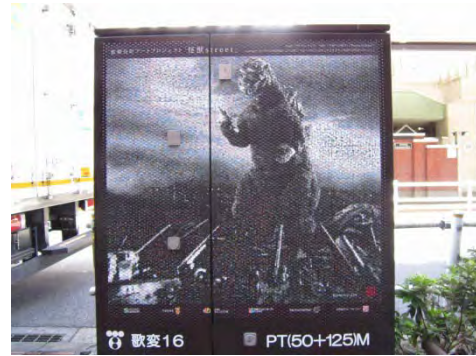
変圧器利用 歌舞伎町一丁目
